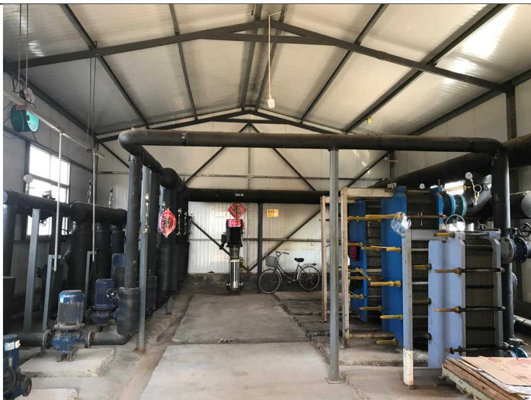
牛庄镇镇政府小区换热机房
