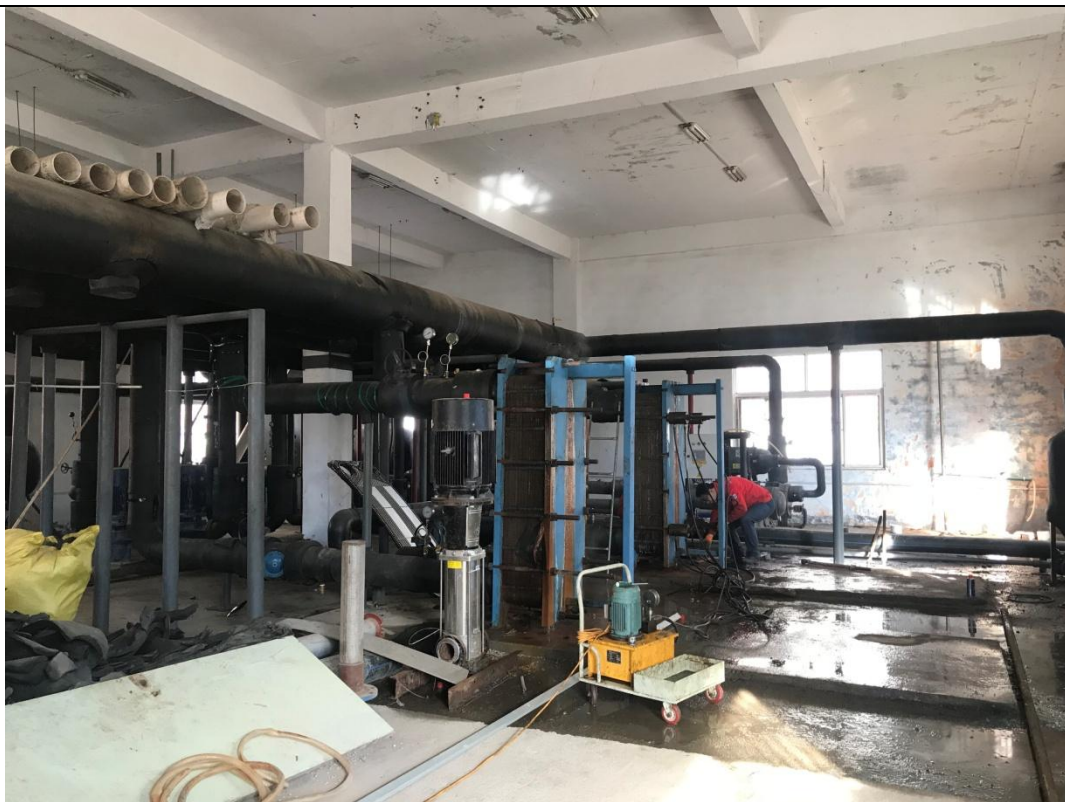
陈庄社区换热机房
