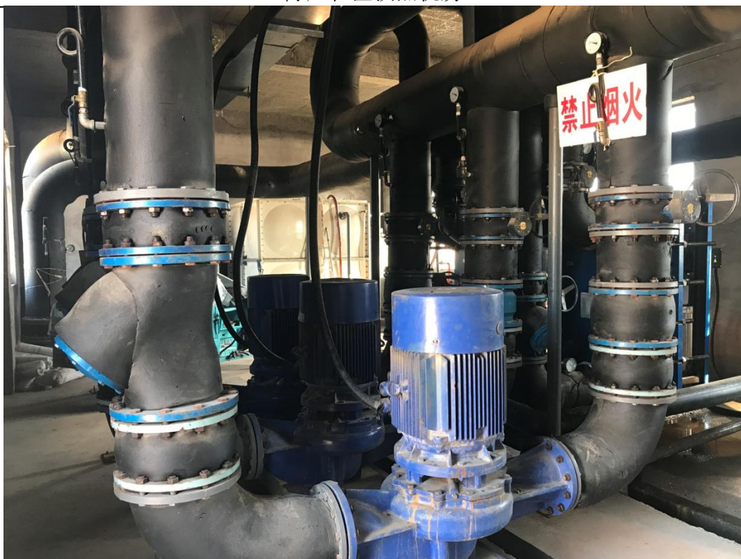
西范社区换热机房
