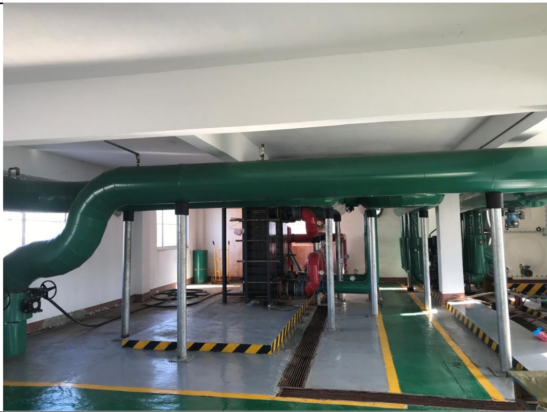
东庞社区换热机房
