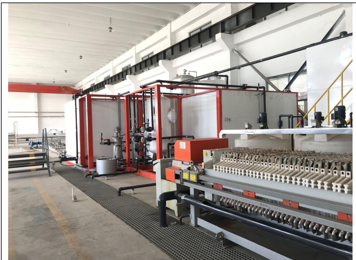
污水处理设施
