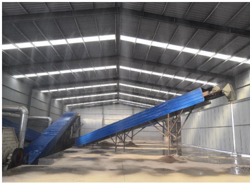
车间顶部喷淋装置
